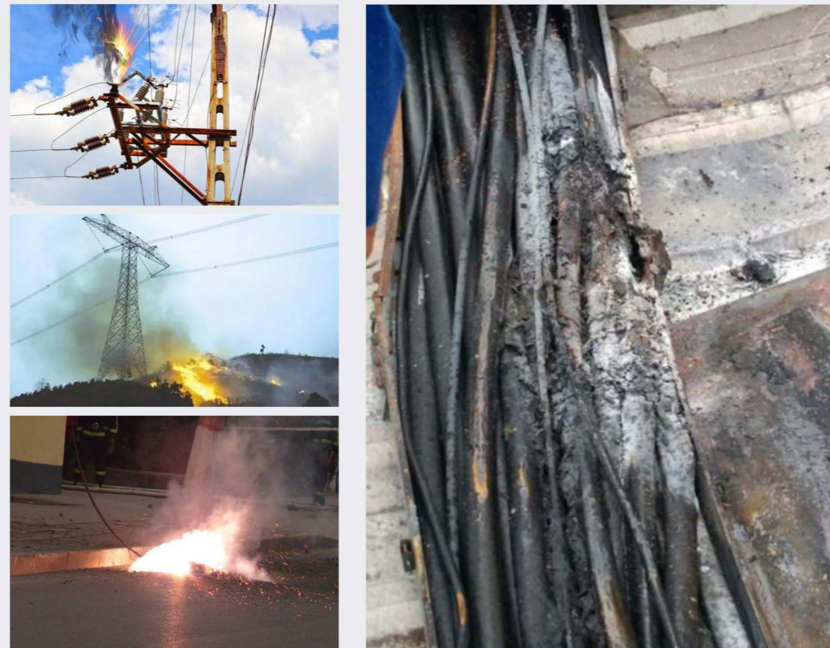
3KV~35KV 架空线路及电缆沟 事故现场示例
