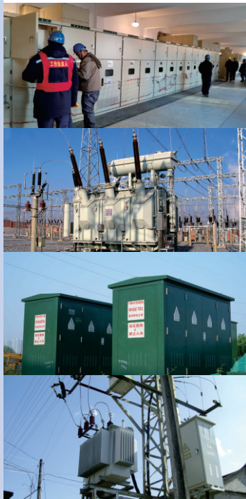
变电站开关柜、变压器，配网环网柜、箱变，农网台区、配电房等
